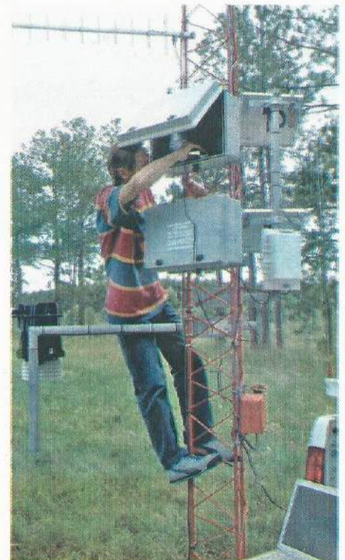
Personal técnico del SMN en tareas de mantenimientos de la Torre Este en proximidades del Puente Internacional Libertador General San Martín, Entre Ríos
