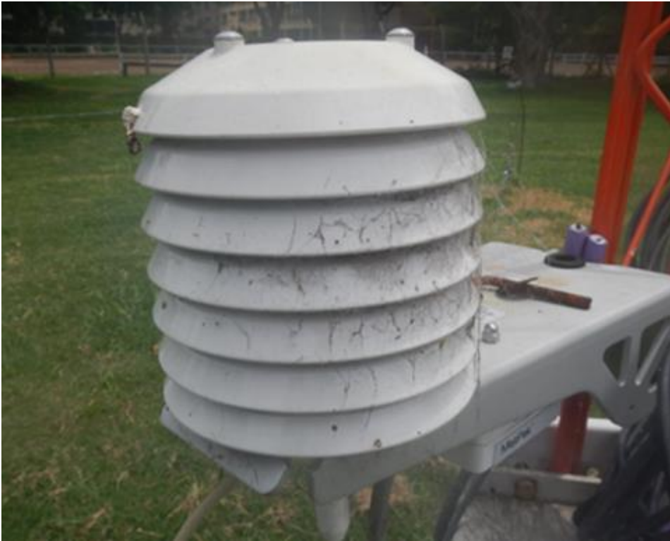
Figura 2: Telas de araña, insectos y plagas juntan suciedad y bloquean la libre circulación del aire que llega al sensor dentro del abrigo, al mismo tiempo que provocan una progresiva degradación del material.
