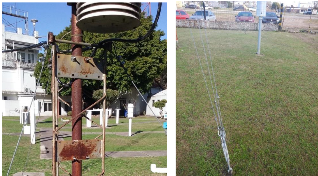
Figura 10: Torre oxidada y tensores de estabilidad.
